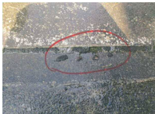
エア一漏れ状況
